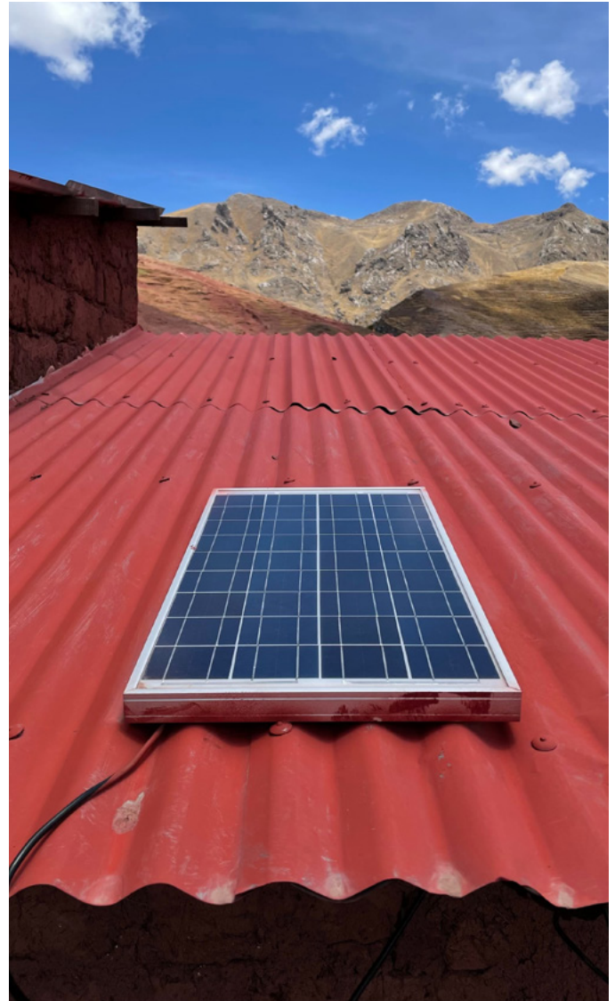
Photo: Panel solar instalado en el techo rojo de una casa en las montañas de Perú. © Flavio Ferraz F
