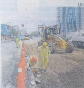
Supervisión. En obras del Estado debe reforzarse.
