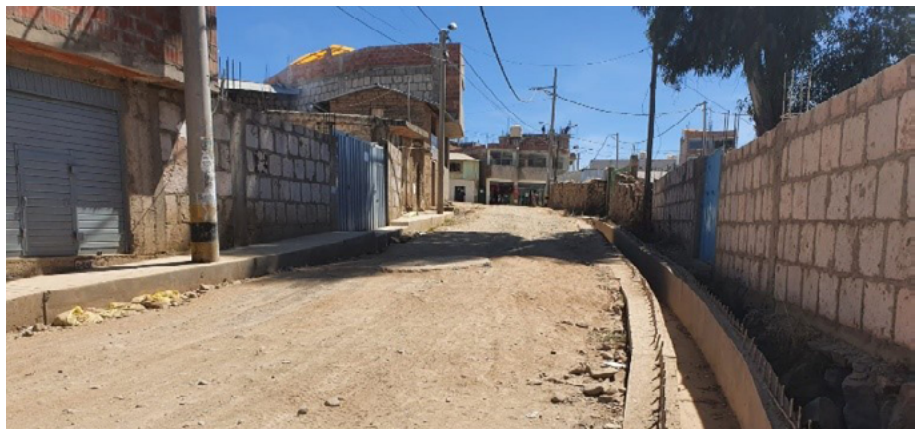
Fotografía de la primera cuadra de la calle Alfonso Ugarte, se encuentra abandonada, con materiales visibles al aire y que se están deteriorando.
