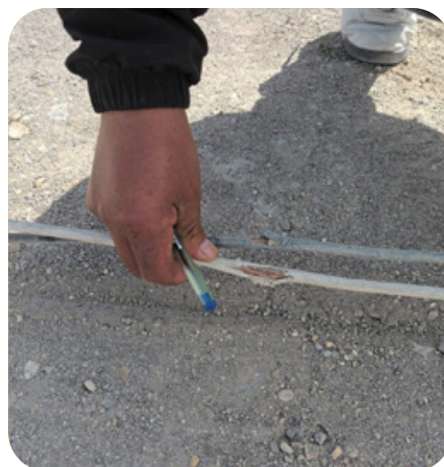
Cable expuesto en la calle
