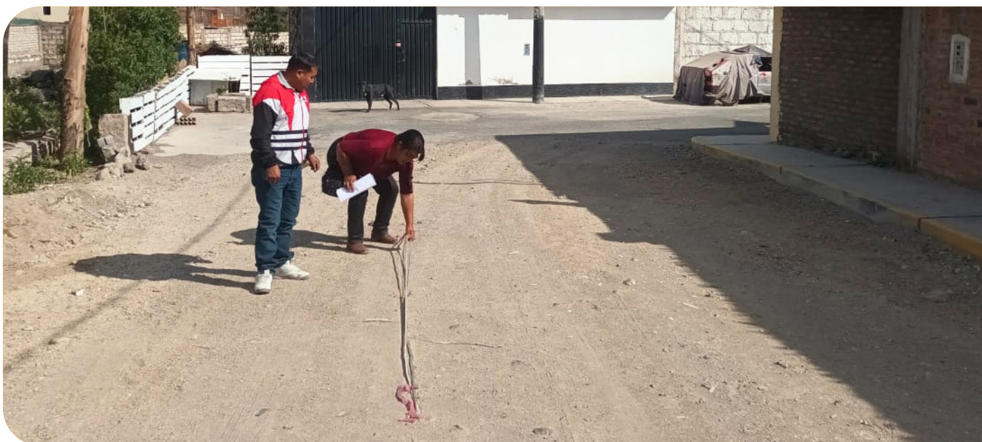
Revisión de cables expuestos en el lugar de la obra
