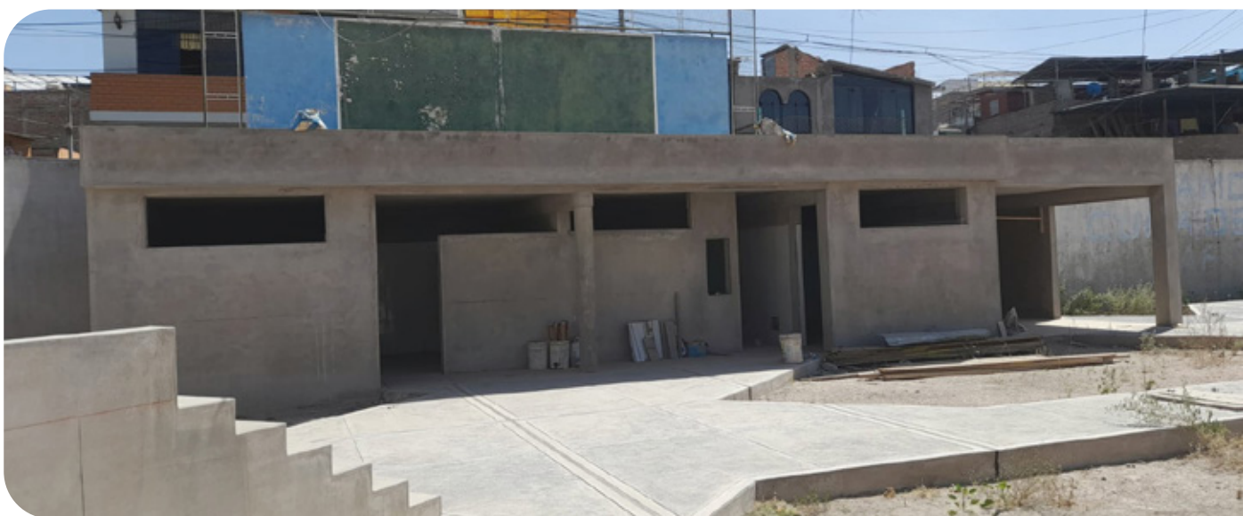
Construcción de baños y vestuarios inconclusa y en estado de abandono
